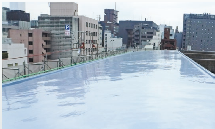
勾配屋根使用例
