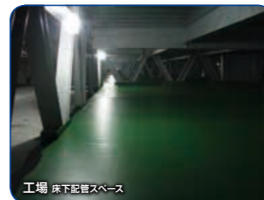
工場 床下配管スペース
